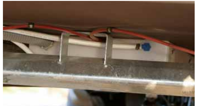
Unterflur: 40 Liter Brauchwasser für die Spüle bunkert der unterflur montierte Tank. Das Wasser wird mit einer 12-Volt-Pumpe gefördert – auch für externen Einsatz.
